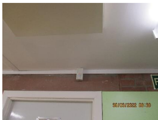
128. Intruder alarm PIR sensor. Corridor.
