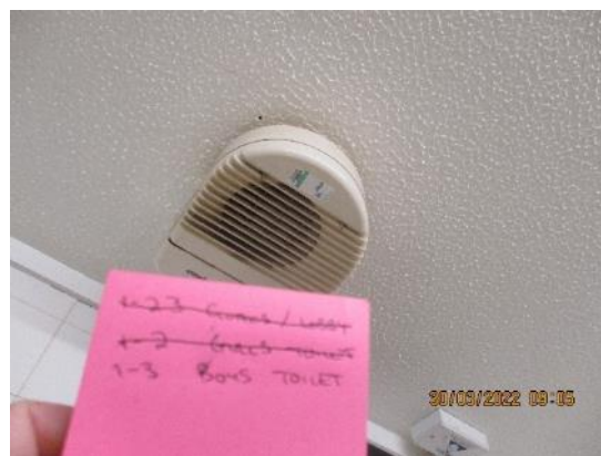
114. Extract fan – boys toilet ceiling 1/3
