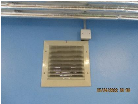
155. Extract fan – boys toilets 1/21.
