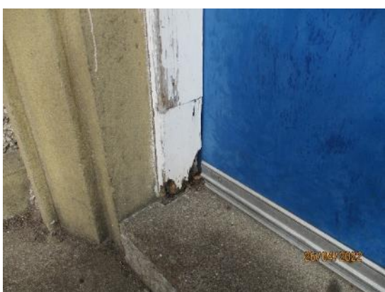
53. Wet rot in door frames
