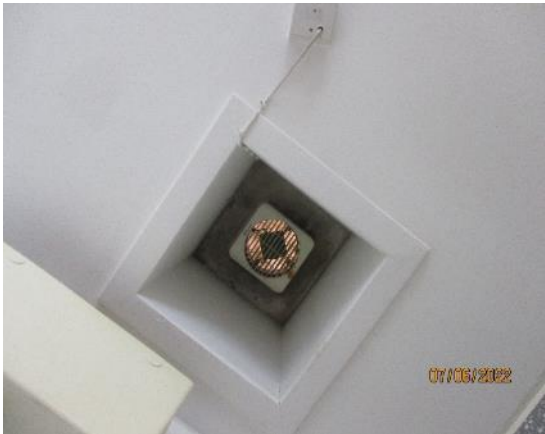
115. Extract fan boys toilets 1-23
