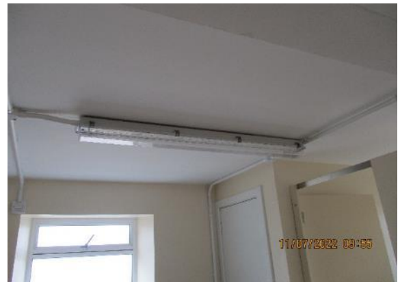
164. Lighting – girls toilet 1/8.
