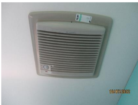
146. Extract fan – boys toilets.
