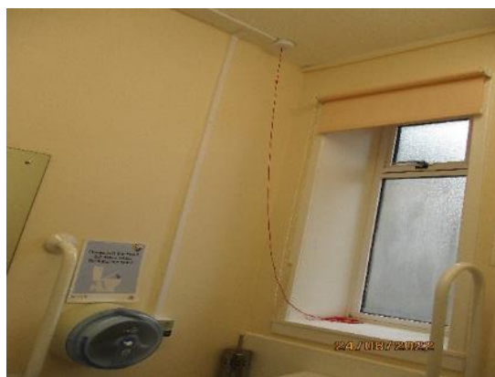
225. Disabled toilet alarm system – (pull chord)
