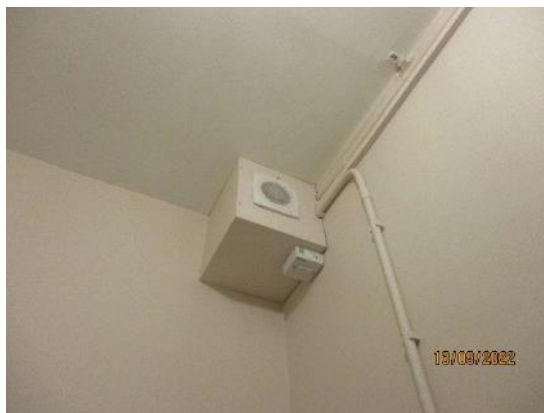
221. Extract fan – staff toilets.
