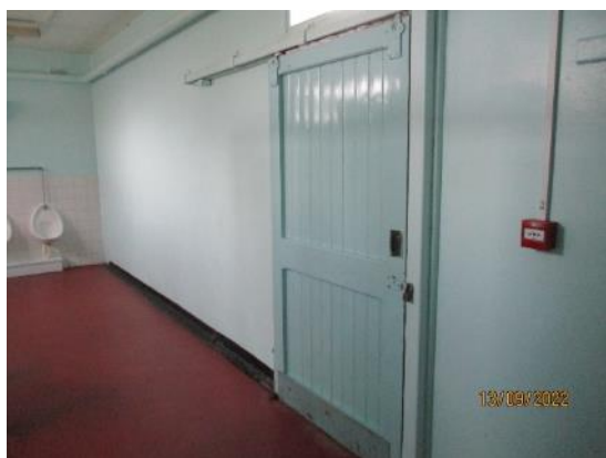
65. Redundant door to Boys Toilet
