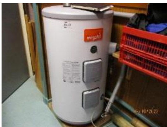
185. Hot water cylinder – PE store.
