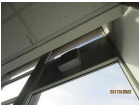
192. Extract fan – boys toilet.
