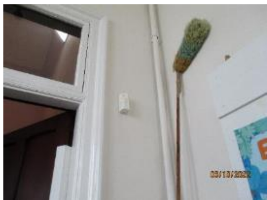
217. Intruder alarm sensor 1/14
