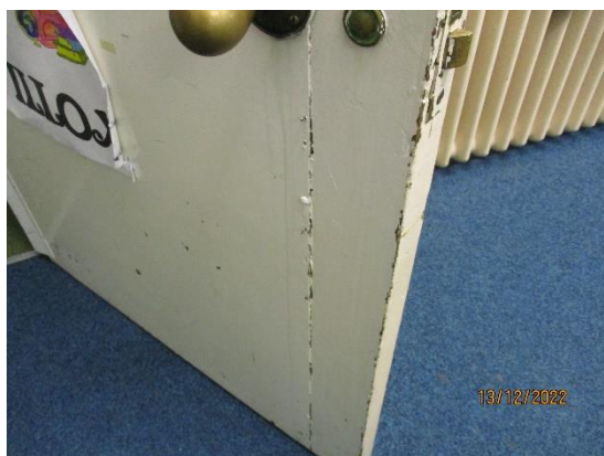
112. Cracked door framing
