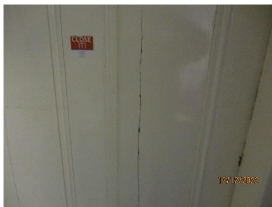
113. Cracked door panels
