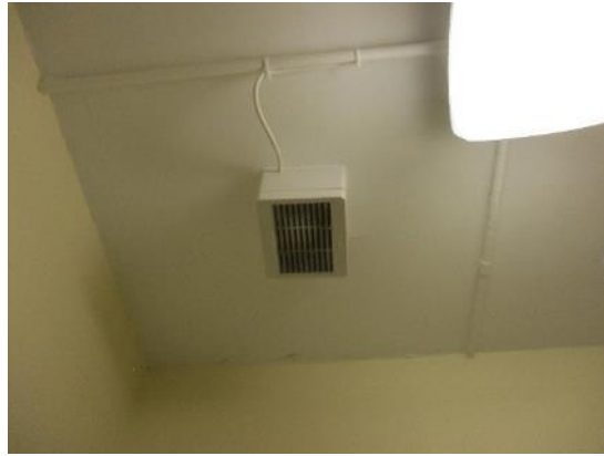
186. Extract fan – staff toilet 1/19
