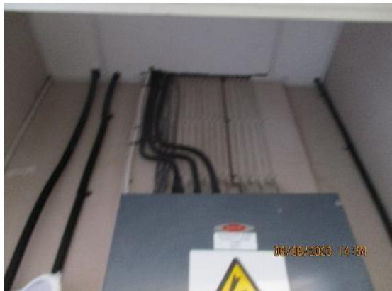
322. General wiring DB 1/42e
