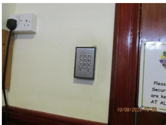
352. Door access keypad – 1/1a internal door.
