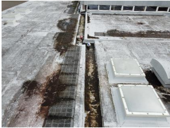
19. SPM box gutters
