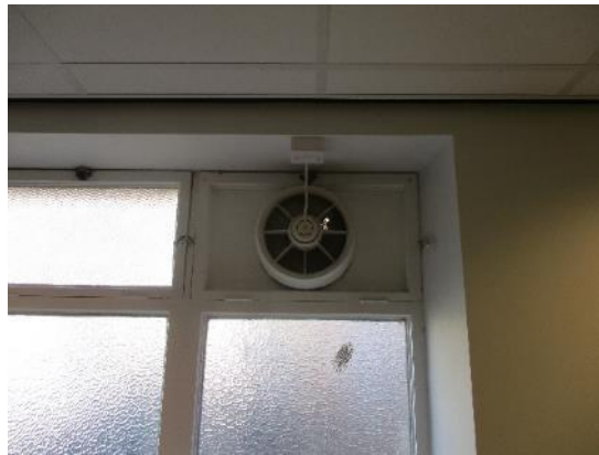
239. Extract fan toilets 1/11 block 1 annexe.
