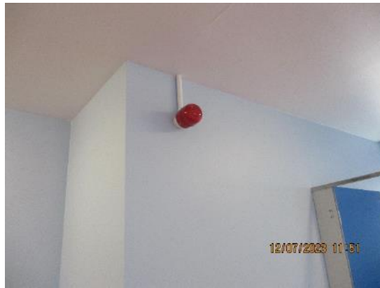
283. Fire alarm strobe boys toilet.
