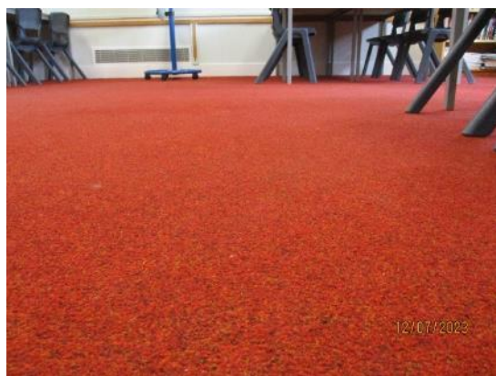
119. Uneven timber floors
