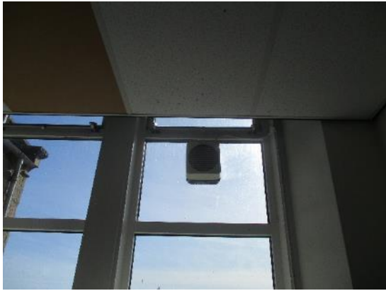
130. Extract Fan boys toilet 1/5
