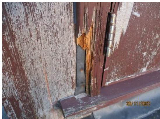
41. Rot in door frames
