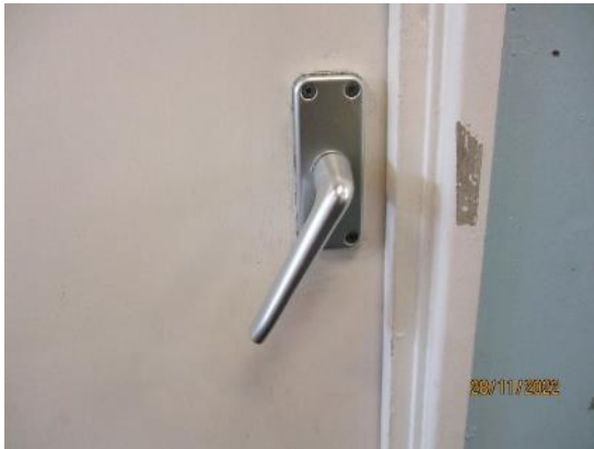
101. Faulty door handles
