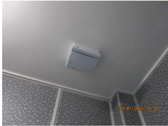
162. Extract fan access toilet 1/19
