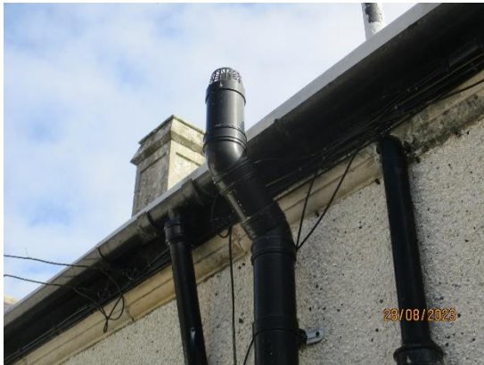
27. UPVC soil vent pipe
