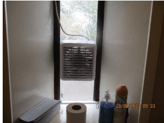
146. Extract fan staff toilet 1/11.
