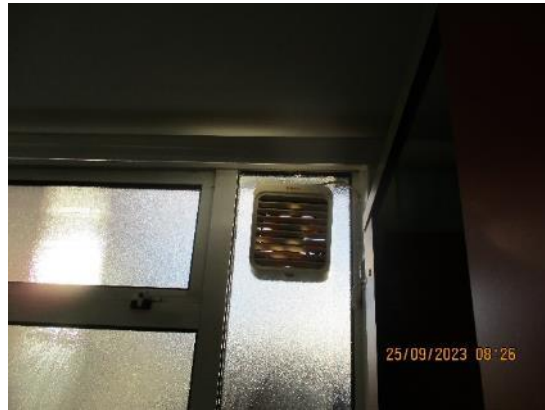
175. Extract fan – boys toilets.
