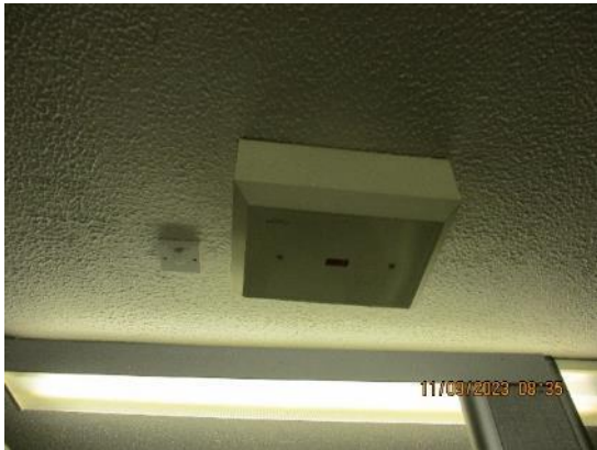
126. Extract fan boys toilets 1/16.
