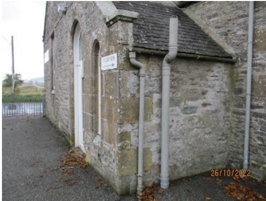
25. UPVC soil vent pipe
